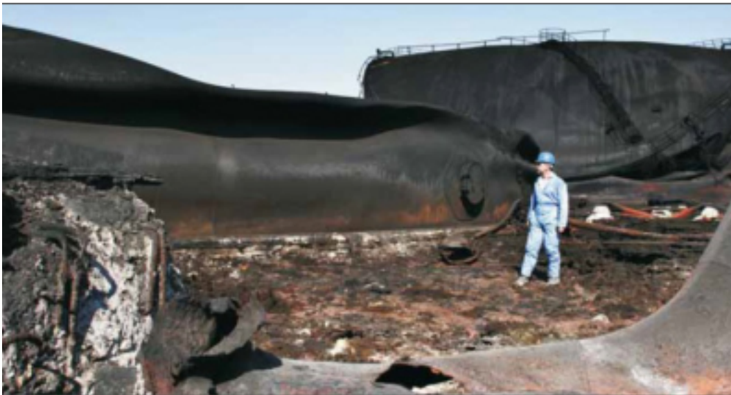
Imagen N° 6: Experto de PNUMA investigando uno de los tanques de almacenamiento dañados en la planta Jiyeh, 2007. Foto: UNEP.
