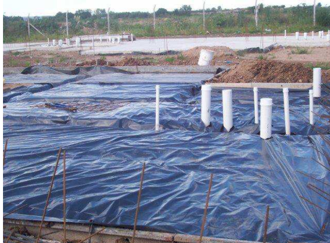
Inicio de las obras del “Plan de Viviendas” en lo que era el campito . (1-02-10)
